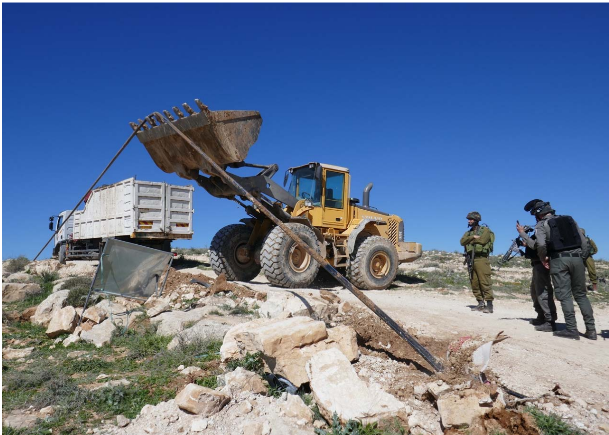
Zerstörung der Wasserleitungen in Masafer Yatta; Foto © EAPPI
